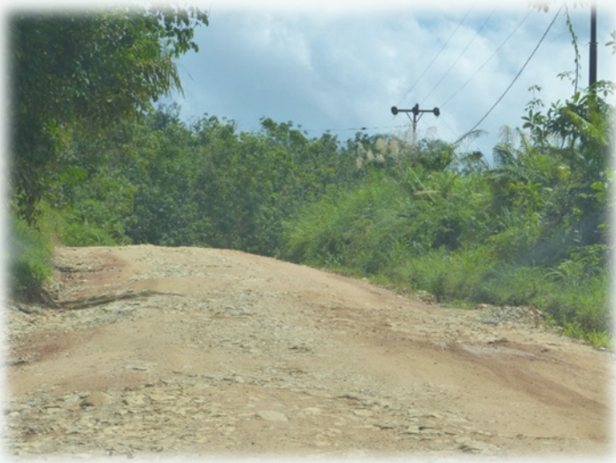
Lampiran 1. Beberapa Kondisi Infrastruktur yang Rusak Parah.
